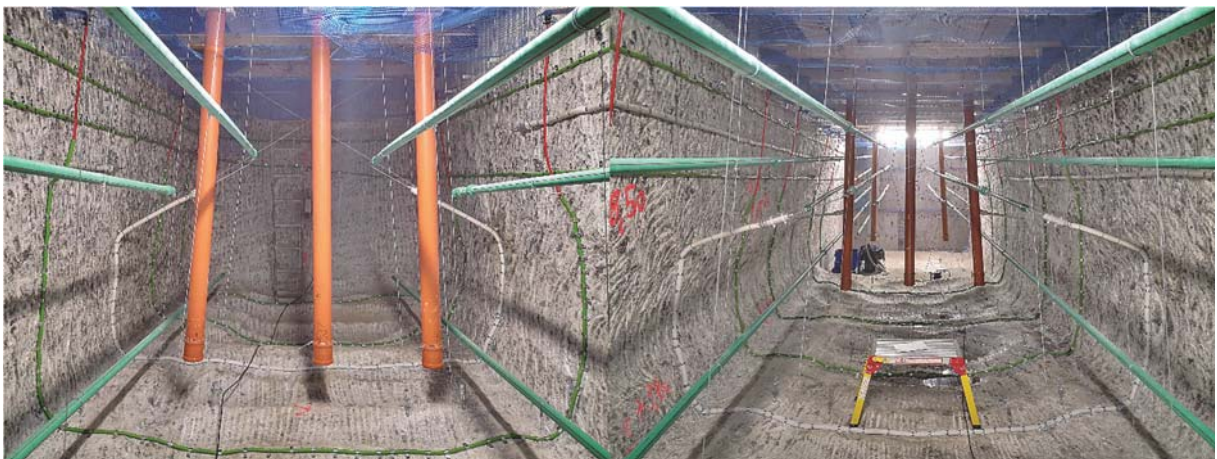
Fig. 6: Blick in die fertiggestellte Installation (links, zum hinteren Stoß; rechts in Richtung der Schalung)
